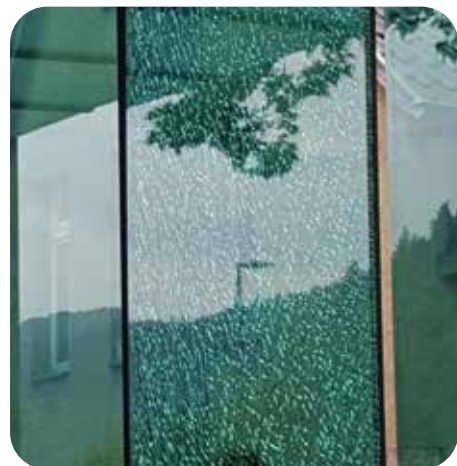
Figura 04: Padrão de quebra do Vidro Laminado com fragmentos colados
